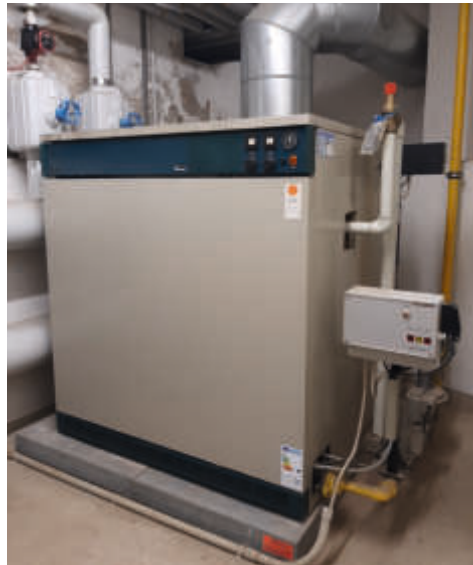
Heizung in der Kirche (Foto: K. Brakebusch)
